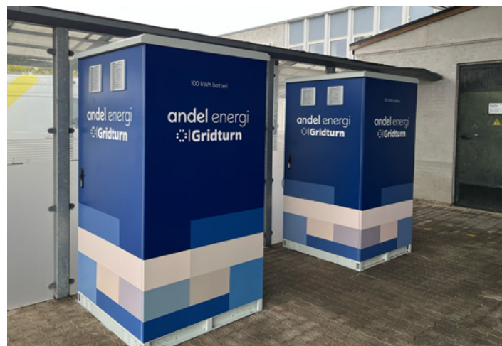
Sammen med Gridturn genbruger vi brugte elbilbatterier til stationære energilagringssystemer.
